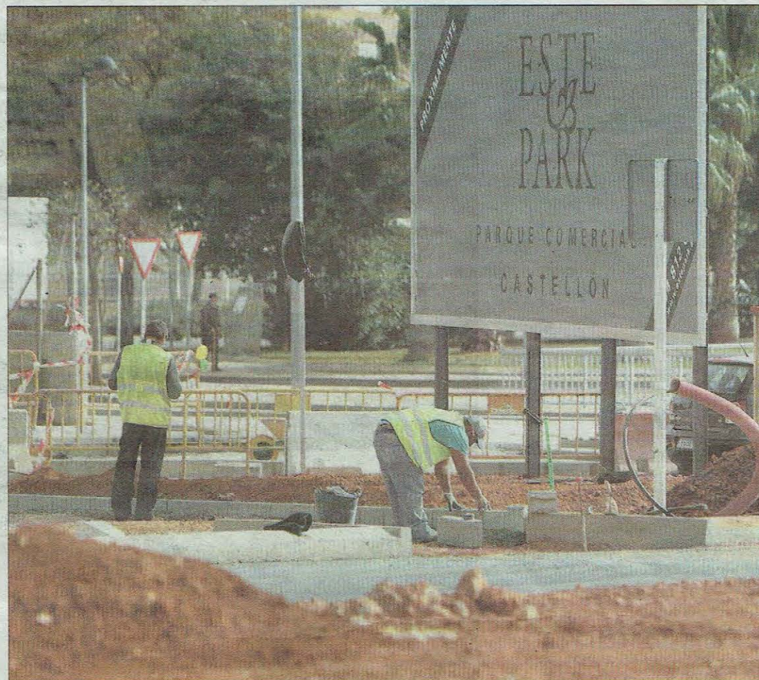
Operarios trabajan en las obras del entorno del futuro centro comercial Estepark. EUGENIO TORRES
